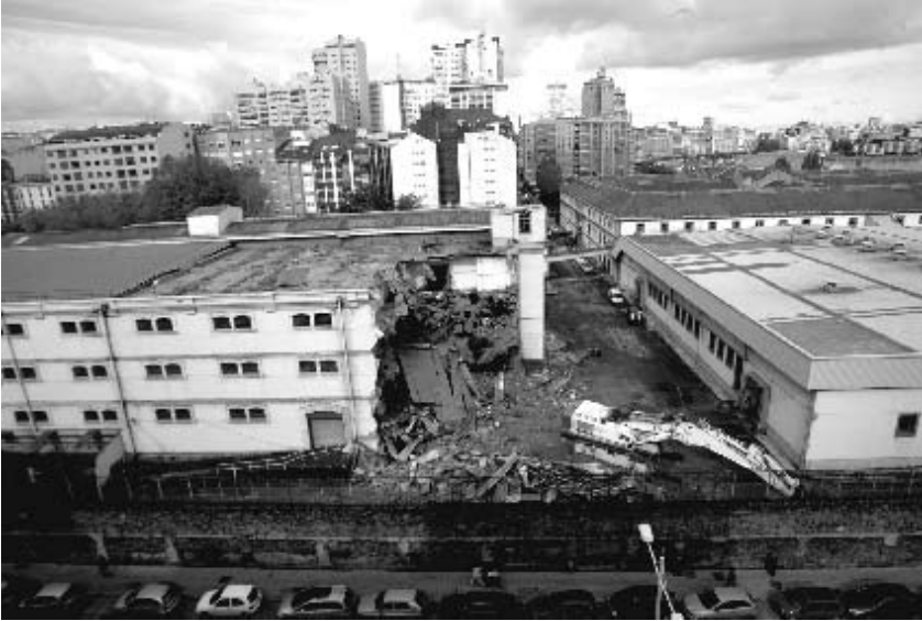
Obras de derrubamento das dependencias da Fábrica de Tabacos 04/10/06. Fotografía de Xosé Castro.
